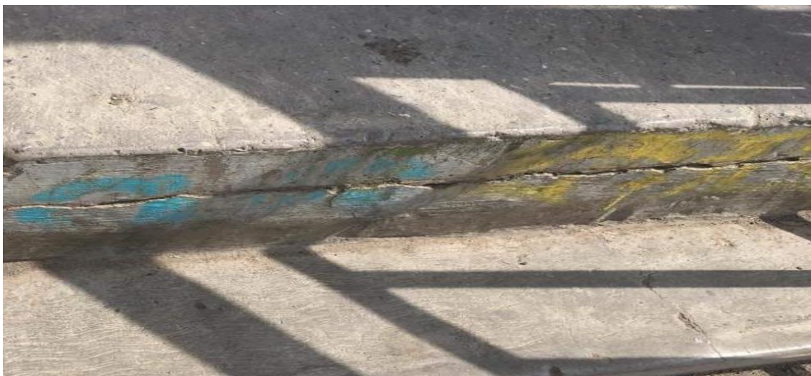
Figura 28. Fotografía de peldaño dañado (Reporte Chalco, 2017).
