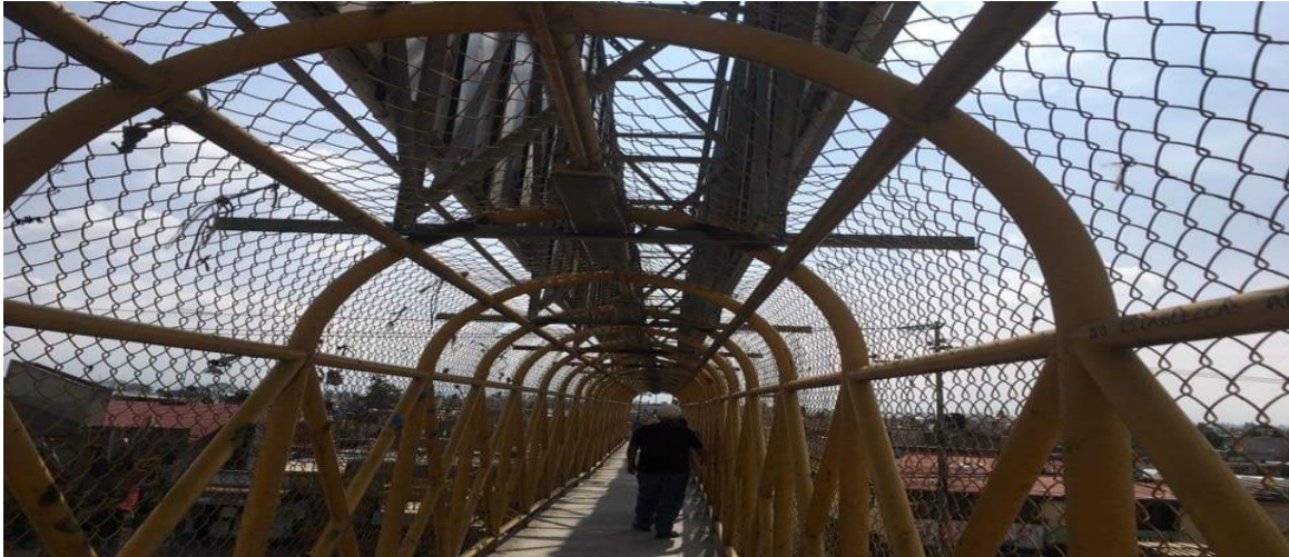
Figura 31. Fotografía de malla dañada por los anuncios publicitarios (Reporte Chalco, 2017).
