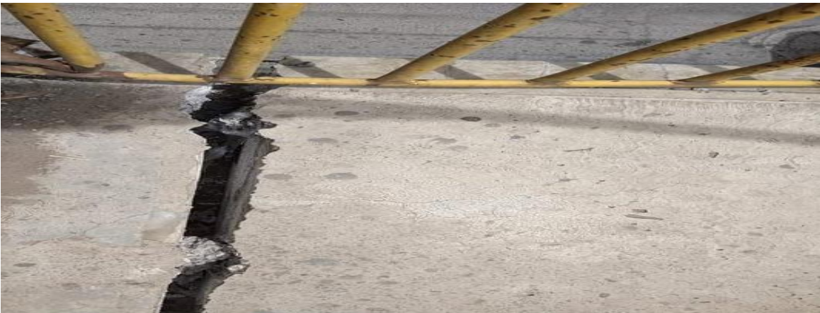
Figura 32. Fotografía de grieta en el piso del puente (Reporte Chalco, 2022).
