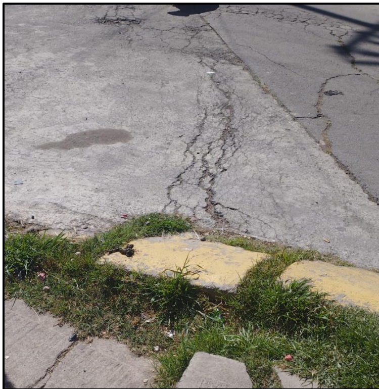
Fotografía 6. Continuación de grieta sobre Avenida Chihuahua
