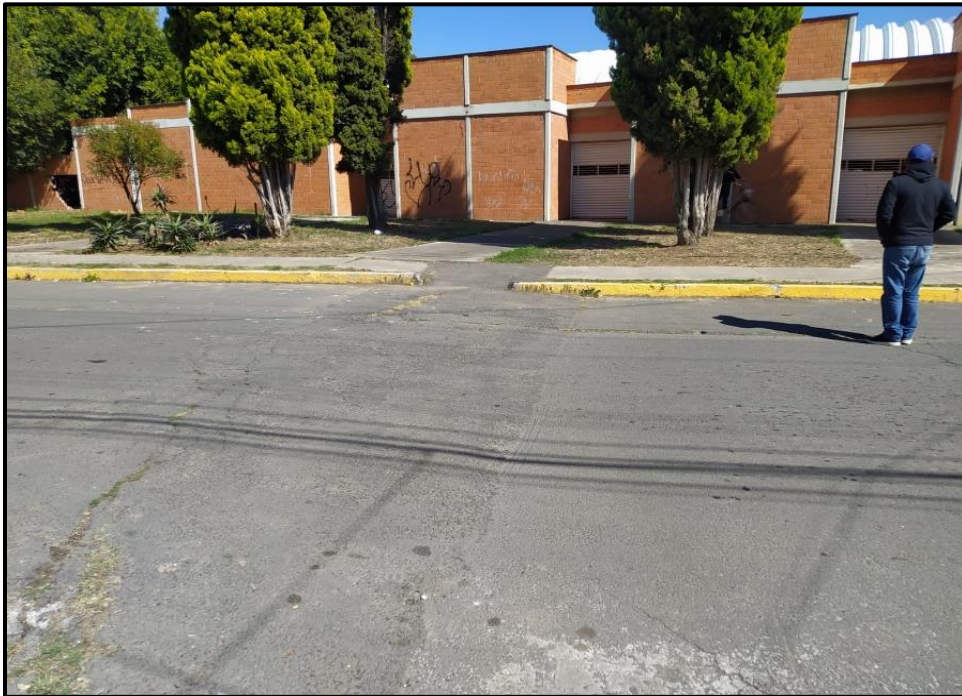
Fotografía 1. Grieta en calle Estado de México
