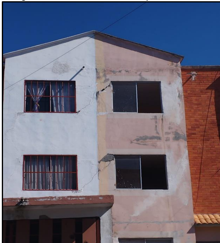
Fotografía 8. Inmueble dañado ubicado en Avenida Chihuahua, Manzana 14
