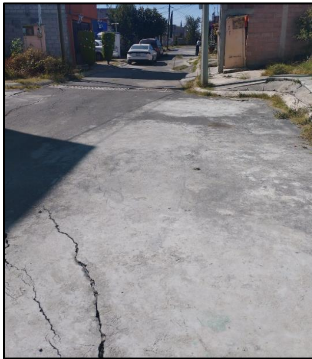
Fotografía 4. Continuación de grieta sobre Privada Tampico
