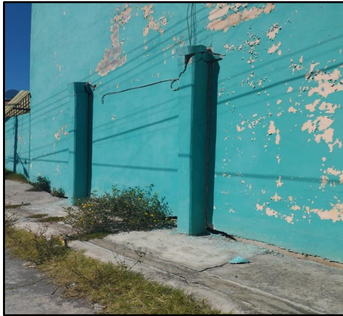
Fotografía 5. Casa con daños estructurales por grietas, esquina Privada Tampico
